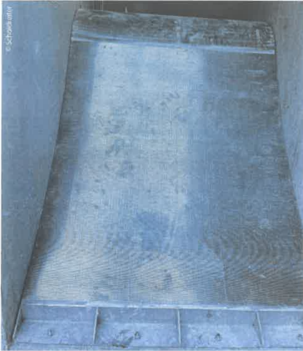
Der Ployergrabenbach ist bekannt für seine hohe Geschiebefracht. Daher wurde auf die Entsandung besonders großer Wert gelegt. GMT lieferte für die Fassung einen angepassten Coanda-Rechen.
