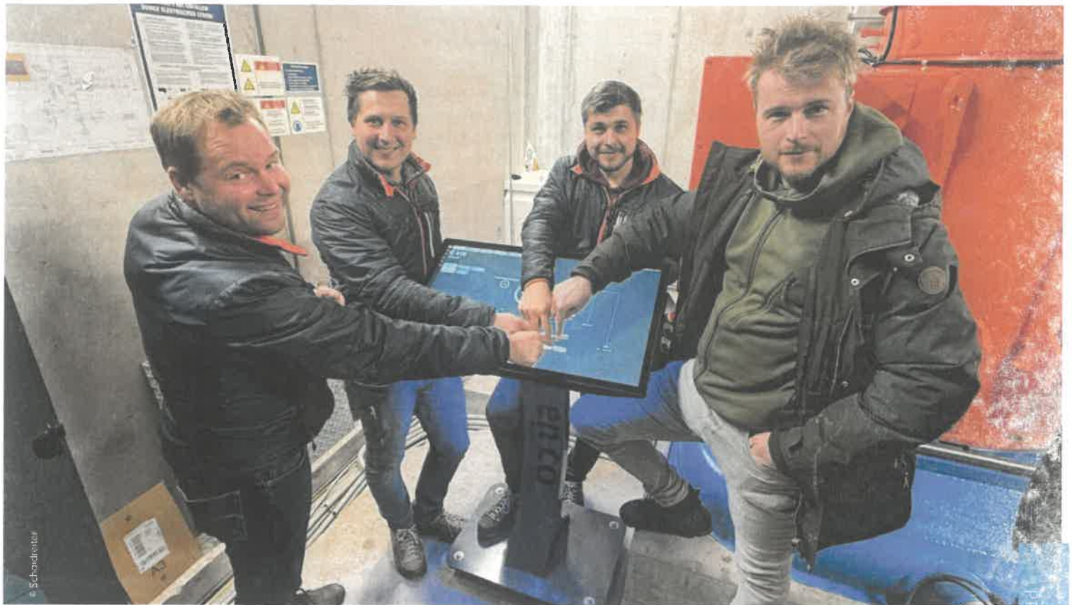
Im Teamwork haben vier junge Pongauer ihr erstes gemeinsames Wasserkraftwerk in Kleinarl verwirklicht. Von links: Philipp Höller, Markus, Christof und Andreas Schaidreiter am modernen Steuerungspult im Krafthaus des neuen KW Ployergrabenbach.
