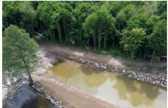
Ein wichtiger Bestandteil des neuen Konzepts war die Verlängerung des Auslaufkanals, was gerade im Hochwasserfall enorme Vorteile für das Kraftwerk bringt.
